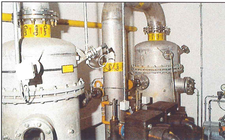
Teilansicht einer Deponiegas-Reinigungsanlage, die nach dem HELASORP®-Verfahren arbeitet
